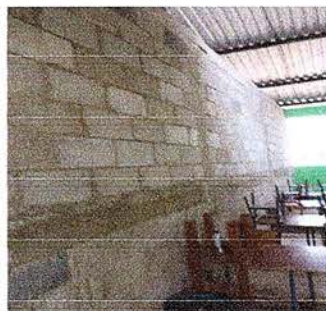
foto 4: repello de pared de aulas.
