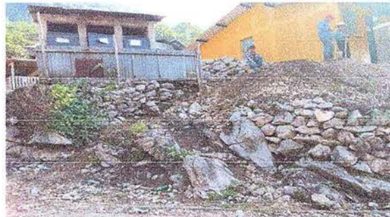
Foto 1.1. Reparación de muros de contención del aula multigrado, complemento de la foto 1, el edificio escolar está en peligro por derrumbe y necesita remodelación.
